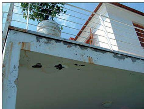
„Málló vakolat az új építésű ingatlan garázsa felett”
